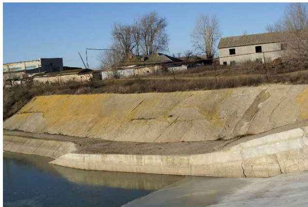
Рисунок 5 – Лебедевка: дефекты плит канала водосбросного сооружения, нижний бьеф
